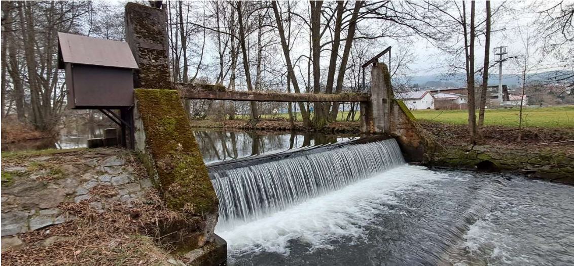
Abbildung 9 Foto der bestehenden Wehrklappe (IB Pfeffer, 2024)
